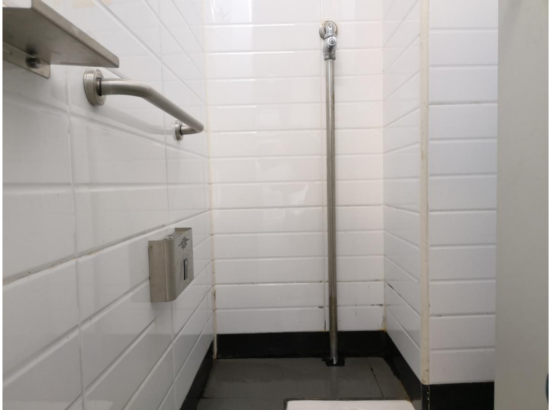
广明高速服务区智慧厕所无线蹲位检测
